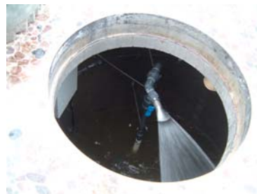
Et kig ned i brønd nr. 1 der rummer en flad hård vandstråle på betonvæggen.
